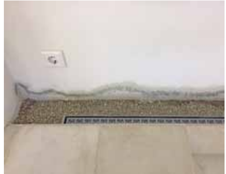
Immer wieder dringt Feuchtigkeit durch das Mauerwerk nach oben.
