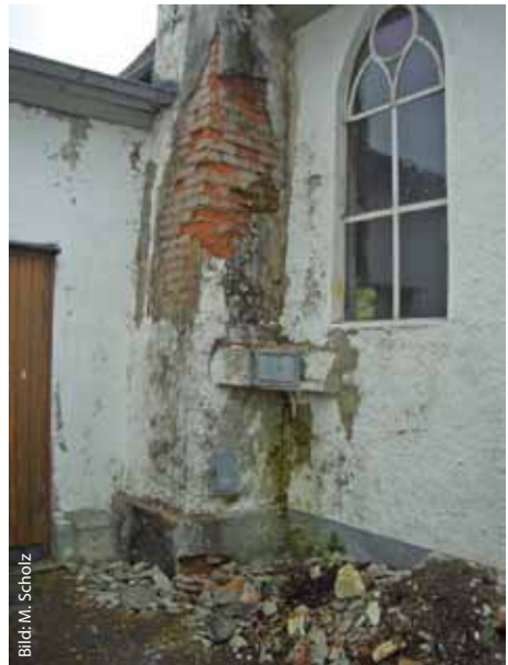
Auf der Nordseite wurden beim Abtragen des Kamins starke Feuchtigkeitsschäden und Vermoosungen sichtbar.
