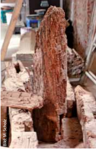
Ein völlig verrotteter und abgefallener Eichenbalken.
